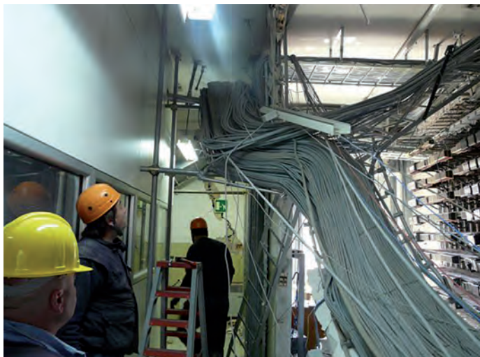
I tecnici di Telecom Italia al lavoro nella sala permutatore di una centrale telefonica a L'Aquila
