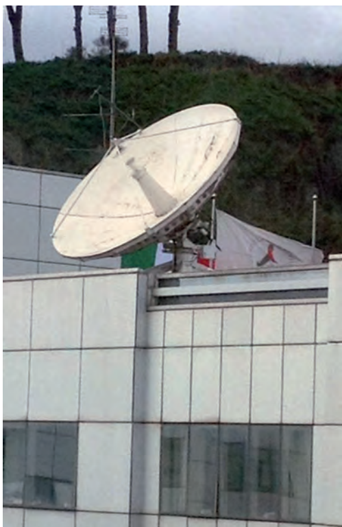
Antenna del sistema Satellitare Pluricanale disponibile presso la sede del DPC
